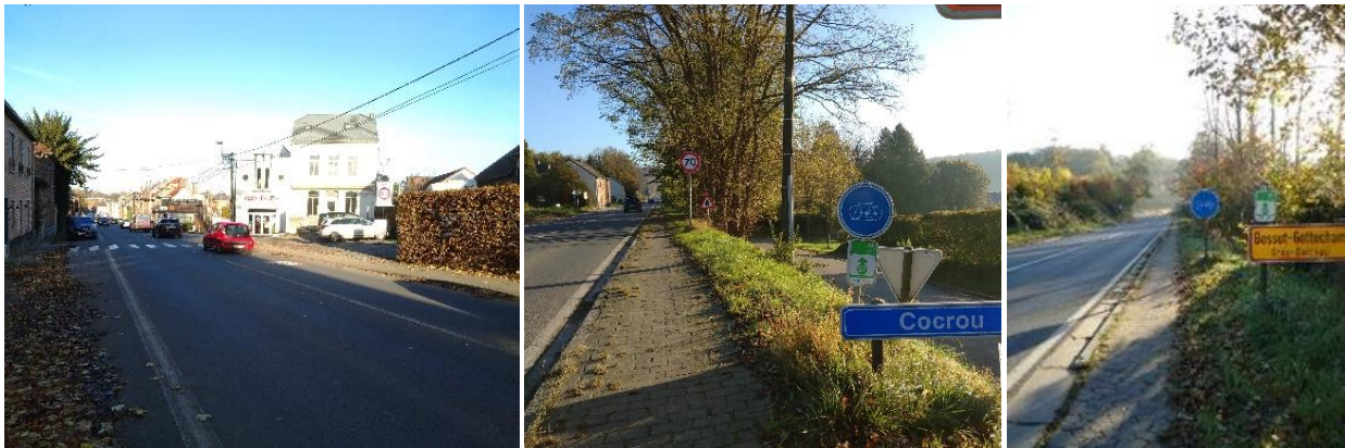
Figure 12 : aménagements défectueux chaussée de Jodoigne.
